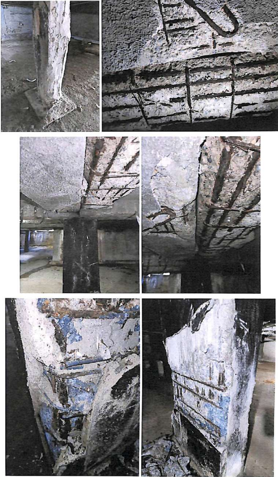
Resim 1. Bodrum kat korozyon hasarı
